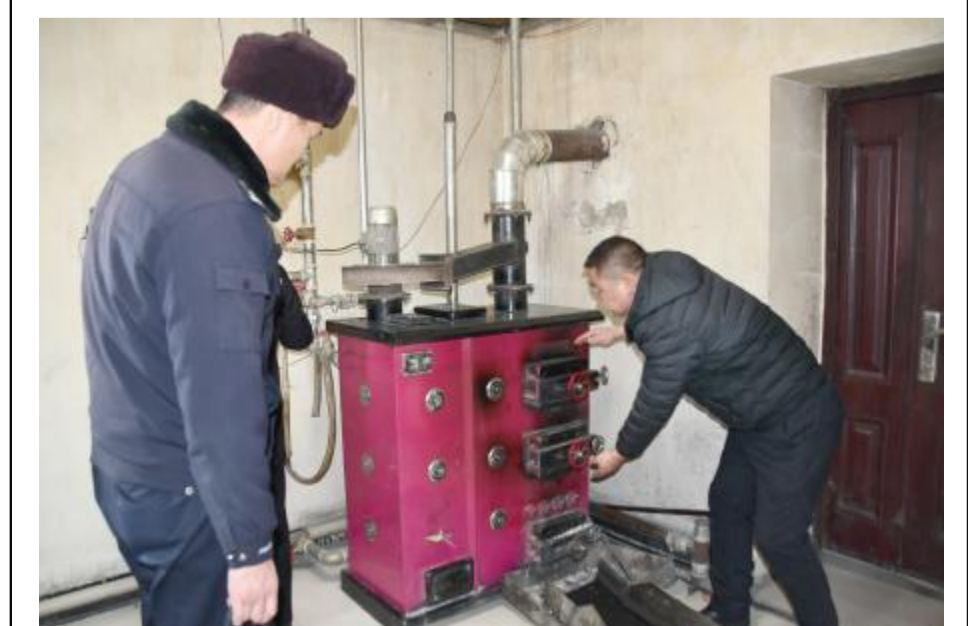
近日,得尔布尔森工公司工会与内蒙古大兴安岭森林公安局得尔布尔分局组成安全生产检查组,深入卡鲁奔健身中心、加油站、林业宾馆等单位,对消防设施、用电管理、室内供暖、值班值守等情况进行检查,将安全隐患消灭在萌芽状态。图为检查组检查林场供暖锅炉。尹达 周志强 摄
