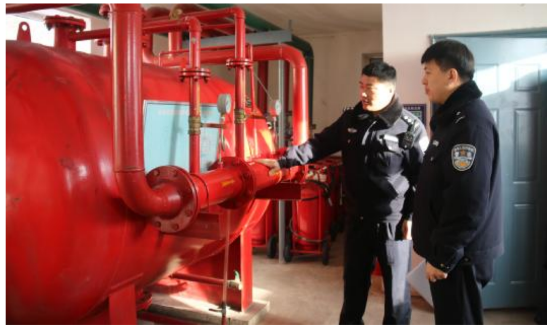
近日,内蒙古大兴安岭森林公安局绰尔分局松岭派出所组织民警对辖区重点单位开展消防安全检查,消除安全隐患,防止事故发生。图为民警在检查油库的消防设备。 ■ 刘晓辉 摄
