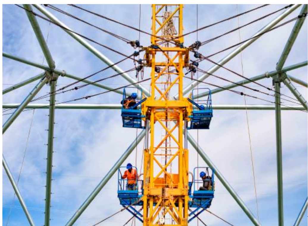
4月17日,工人在张北—胜利1000千伏特高压输电交流项目工程内蒙古段进行组塔作业(无人机照片)。
