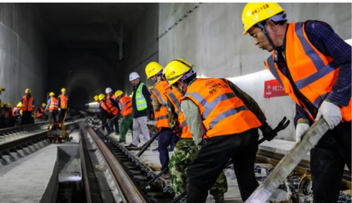
1月6日,施工人员在广佛东环城际铁路大源站铺轨施工现场铺设全线最后一组500米长钢轨。当日,由中铁二十五局承建的广(广州)佛(佛山)东环城际铁路全线铺轨完成,项目实现“轨通”。广佛东环城际铁路是广佛环城际铁路的一段,也是粤港澳大湾区城际铁路网的重要组成部分。
