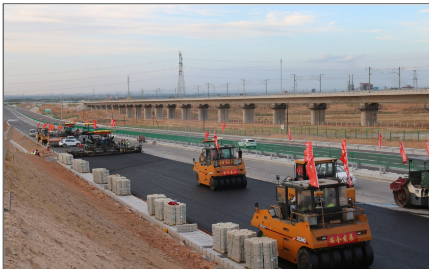
经过建设者近两个月的不懈努力,京藏高速公路改扩建工程22合同段下面层摊铺施工于6月16日顺利结束。该标段全长17公里,需摊铺下面层沥青混凝土5.28万吨,自4月27日正式摊铺以来,各参建单位上下一心,加班加点,不断掀起大干高潮,保进度、保质量,安全生产文明施工,有效保障了工程施工的顺利进行。
