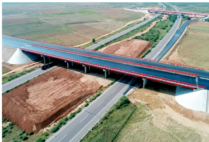
银百高速公路三标全长28.97公里,主线按双向四车道高速公路标准设计,路基宽度26米,中面层厚度6厘米。截止目前,该标段主线沥青中面层摊铺施工任务全部完成。经检测,厚度、压实度、平整度等各项指标全部合格。
