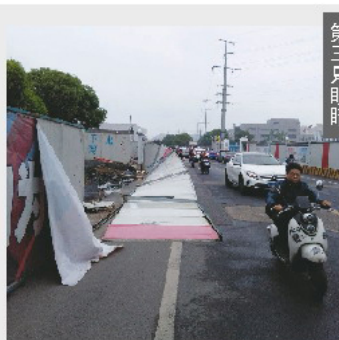
5月22日凌晨,苏州高新区长江路与向阳路交汇处西北角一侧发生交通护栏倒塌事件,当时未造成人员伤亡事故。李师傅说,护栏倒伏在主干道上约30多米。上班高峰期人车流量较大,存在较大交通安全隐患,希望有关单位尽快修复,减少事故发生,否则后果不堪设想。张开卫/摄
