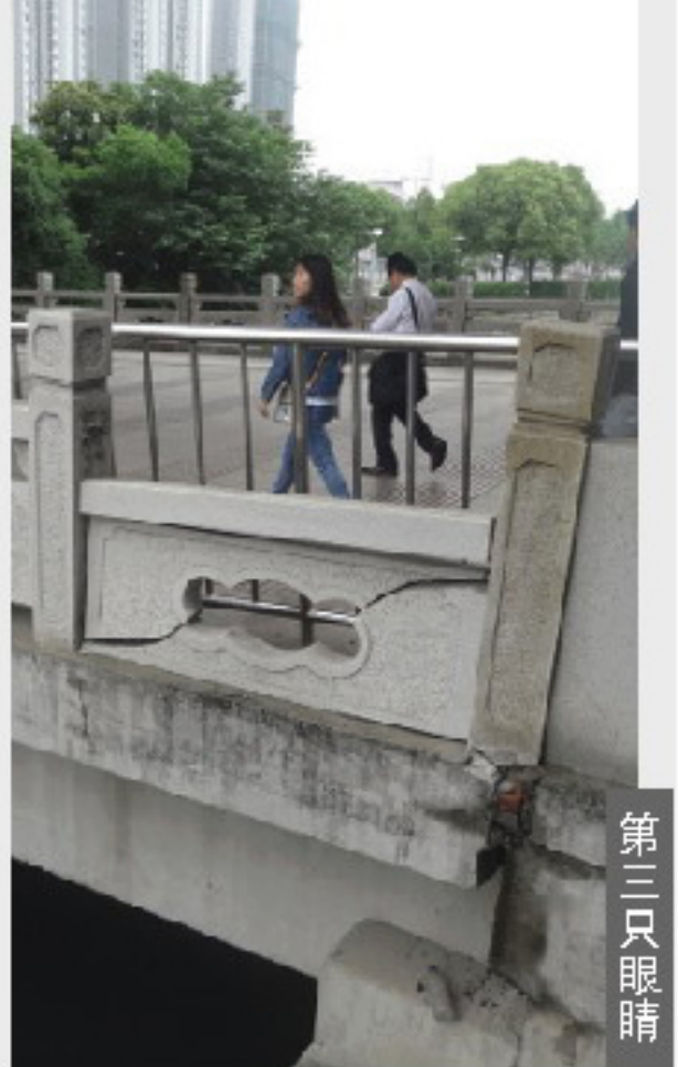
日前,在铁路昆山站看到过河通道桥栏杆破损,虽然外面临时修了不锈钢护栏,但为了安全起见,还望铁路部门及时维修好为好。
