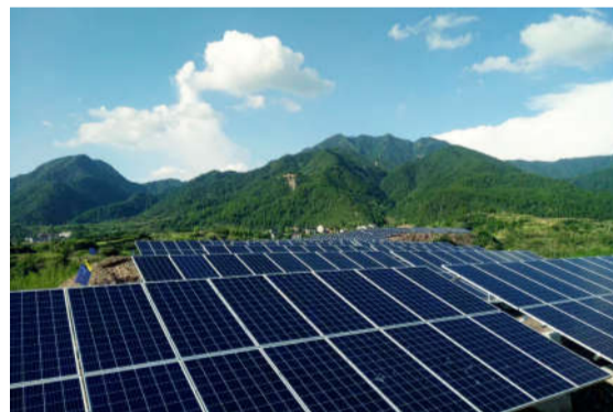
太阳能光伏发电项目
